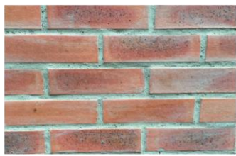
Кирпичный фасад до очистки
